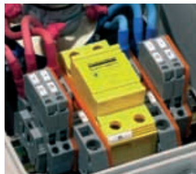
Überspannungsableiter im Gleichstromhauptschalter 2.0
