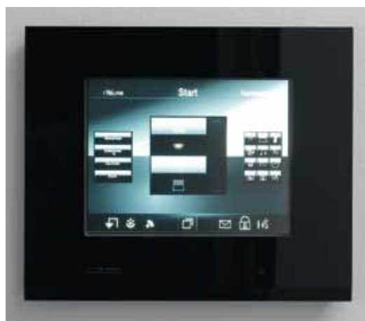
Alle Hausfunktionen können über das zentrale Schalt- und Melde-tableau bedient werden. Sowohl der Zustand der Elektroanlage als auch Fehlermeldungen werden angezeigt.
